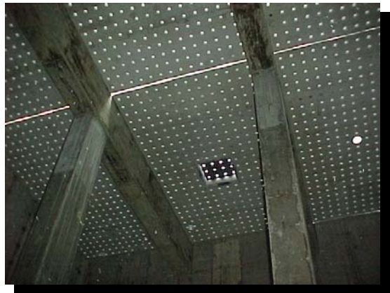
BAF Plenum Floor
